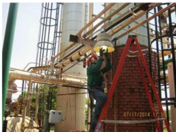
Contrato 5213716 Año 2014 Mantenimiento Eléctrico
