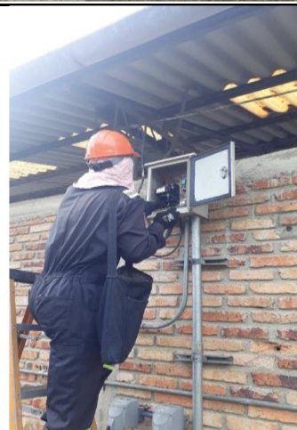
Contrato 3006246 Año 2018-2020 Mantenimiento Redes Eléctricas GMA-GCT-GRI-CGO
