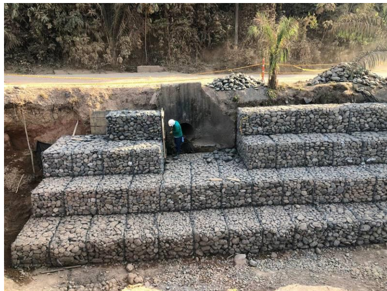
Gaviones Via nacional Contrato 3028575
