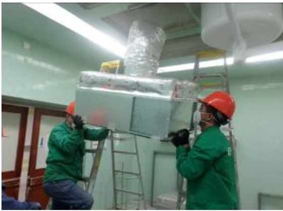
Contrato 3002470 Año 2016 Aires Electromecánico Policlínica
